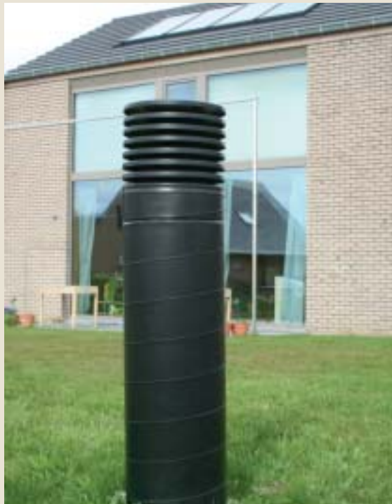
In de zomer kan je de warmtewisselaar uitschakelen en is er via de aardwarmtewisselaar (een buis die de lucht 40 m lang onder de koude grond aanvoert) een toevoer van frisse buitenlucht. Foto Frank Thielens
